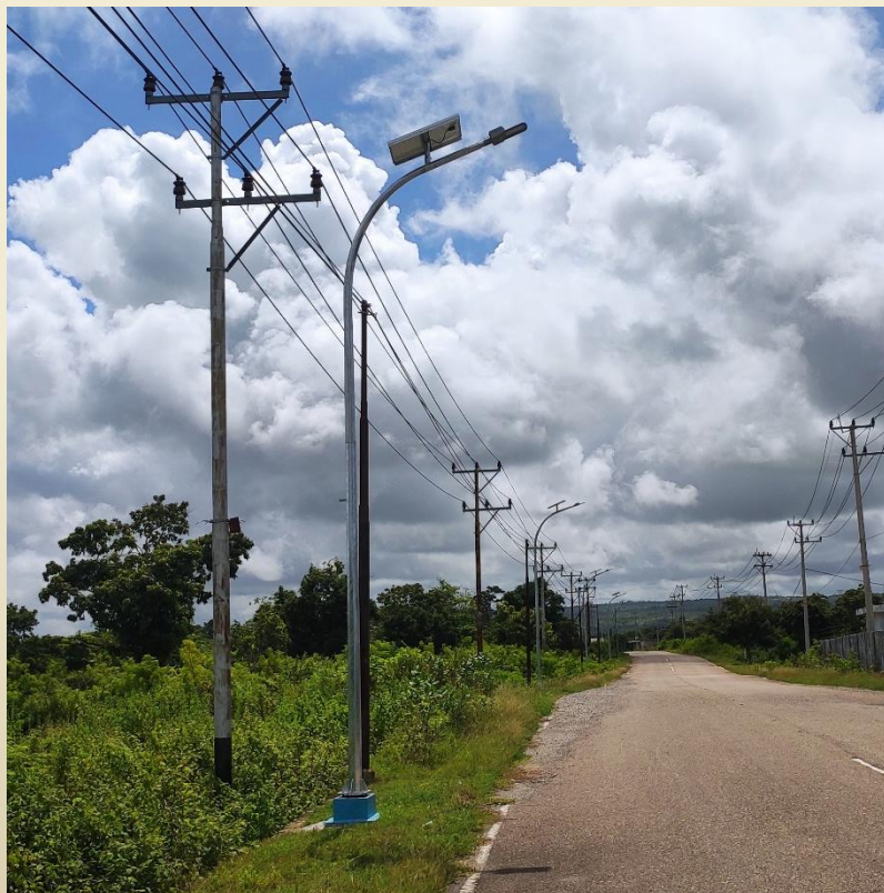
Lampu Penerangan Jalan
